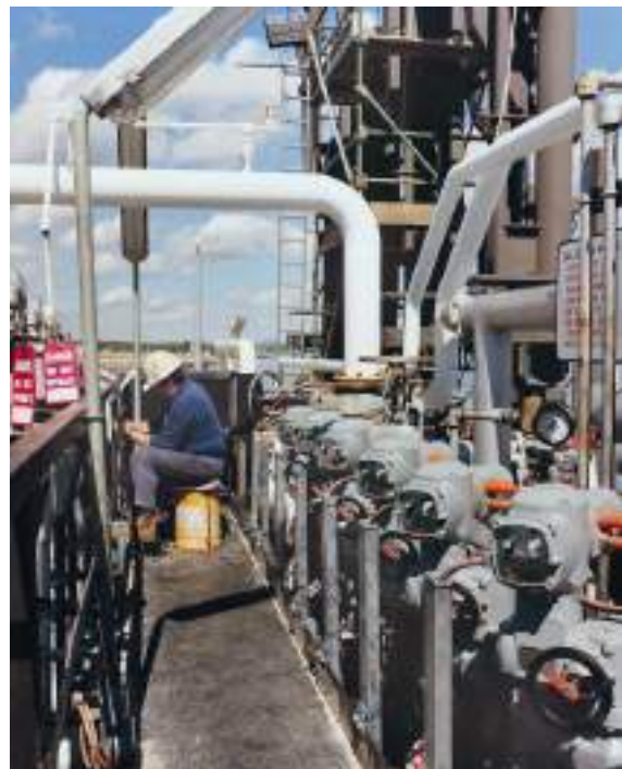
FOTO A: Batteria di valvole motorizzate con attuatori AUMA MATIC in versione Profibus.
