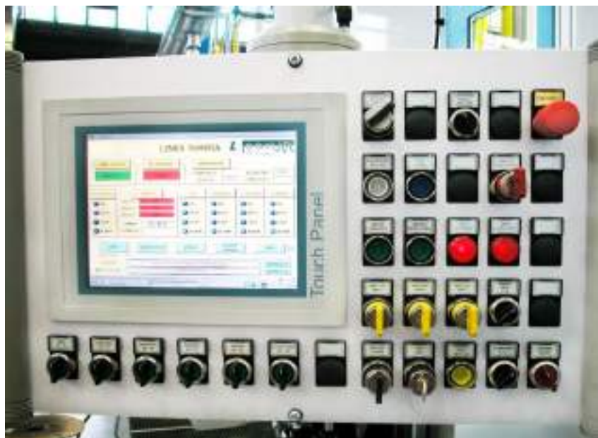
Particolare di una delle postazioni 3 sottostazioni di lavoro della linea. Ogni sottostazione dispone di una postazione comandi operatore con touch panel basato su Windows CE ed HMI Movicon, connesso in rete con il supervisore centrale.
