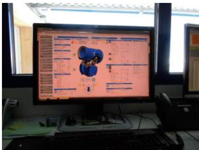
Una delle postazioni di controllo del sistema di supervisione Movicon di St. Moritz - Engadin
