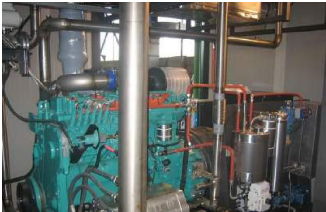
L'interno della cabina di un gruppo di produzione di energia elettrica-termica da 100 kW prodotto da Powertron. Il sistema può funzionare in media oltre 650 ore/mese continuamente.
